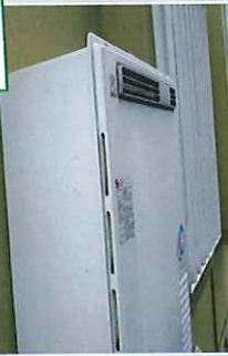
都市ガス 給湯器 取替え前
